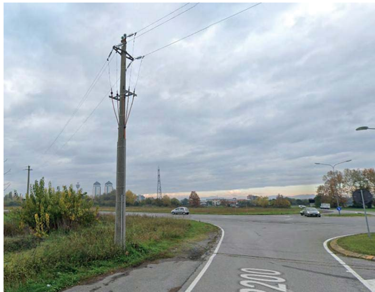
Traliccio Enel media tensione interferente
