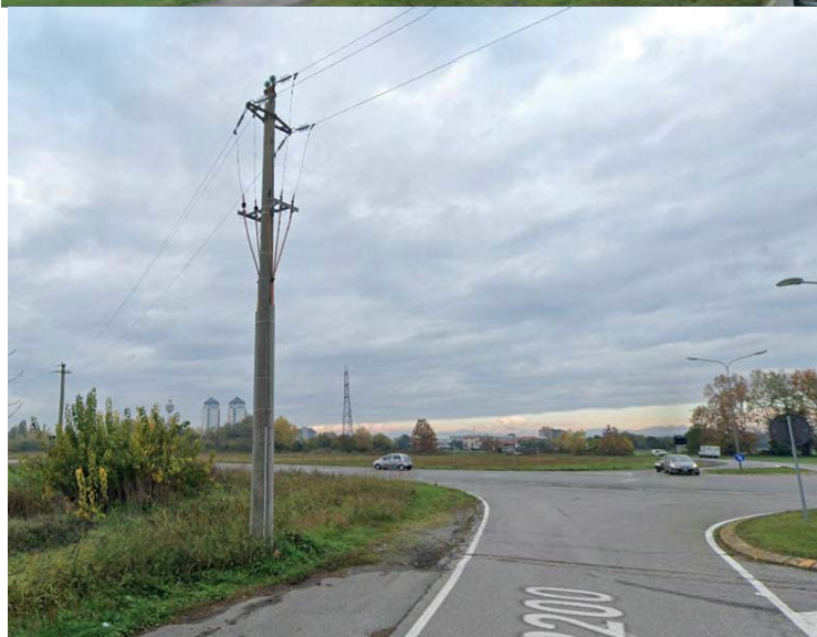
Traliccio Enel media tensione interferente
