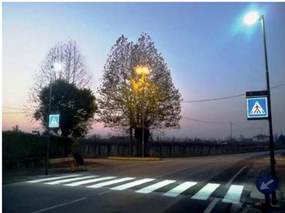
Attraversamenti pedonali luminosi (APL) con e senza portale
